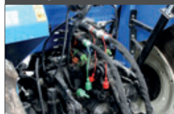
Branchement hydraulique directement sur le tracteur
